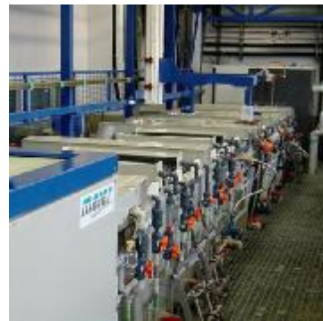
Geplant von RHB GalvanoConsult Elektropolieranlage mit Vakuumtrocknung
