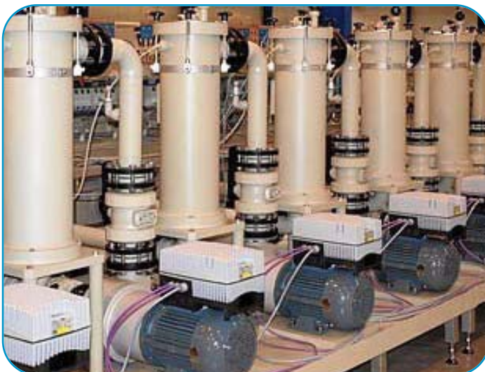
Einsatz von Kreiselpumpen und Kunststofffiltern in der Galvanotechnik
